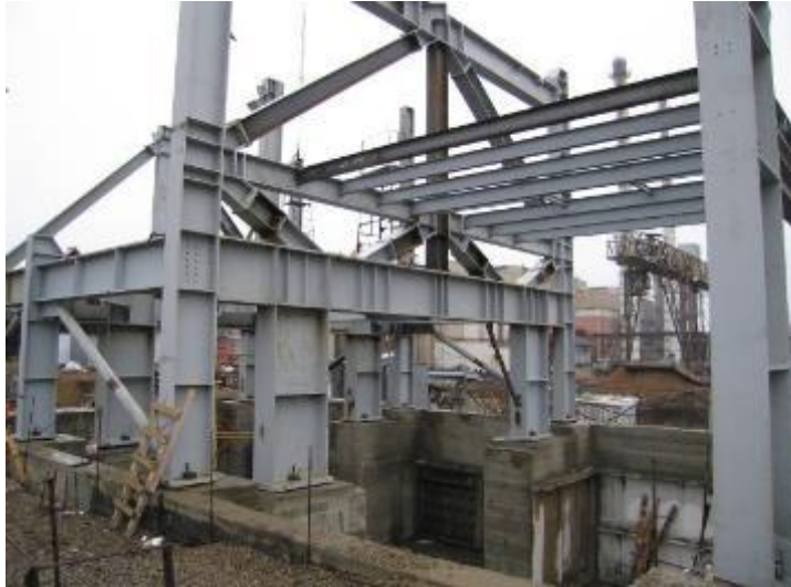
Основные несущие конструкции бункеров - реализация
