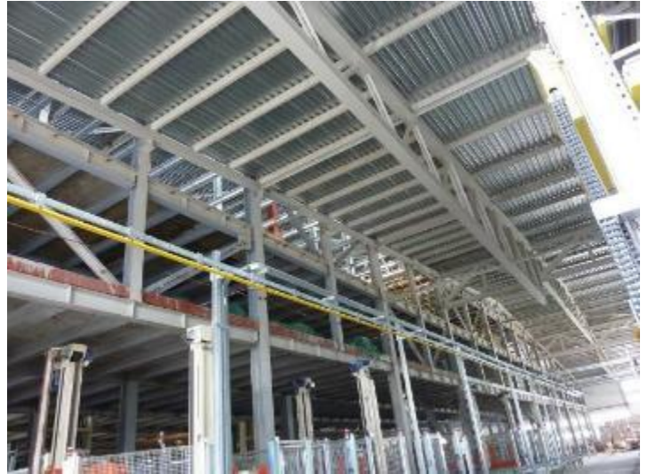
Производственный моноблок (плавильный цех) изнутри
